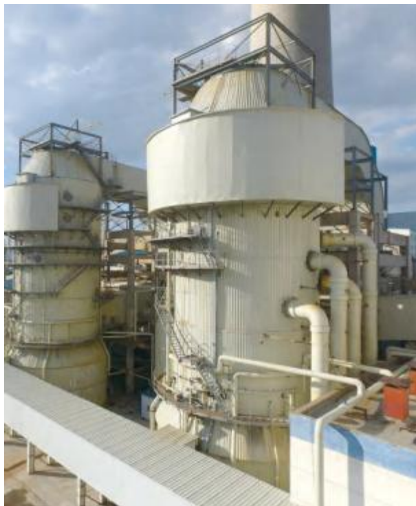
北方联合电力有限责任公司包头第二热电厂改造后的4号机组超低排放设备
